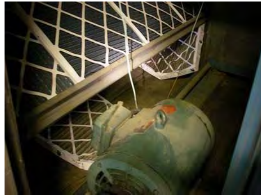
LOOSE FAN FILTERS
