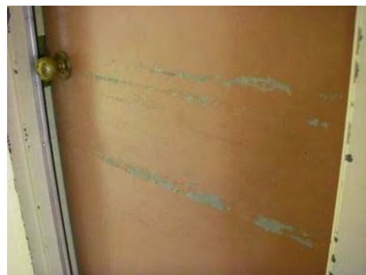
DOOR COATING GOUGED
