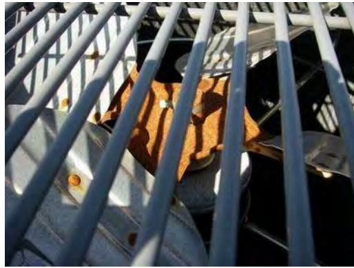
CORRODED CONDENSER FAN BLADE
